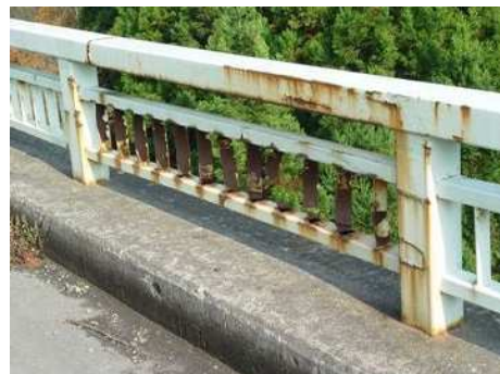
写真 1 高欄部材の欠損
