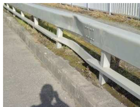
写真 2 防護柵の著しい変形
