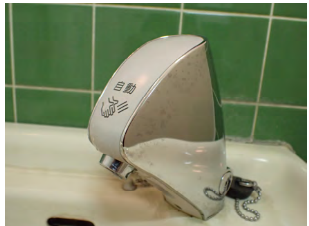
博物館トイレ自動水栓化（21.8.20）
