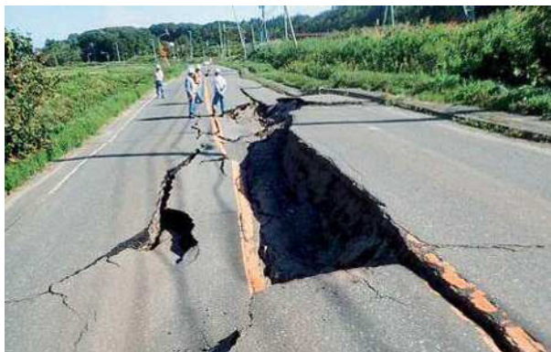
道道平取厚真線 (宇隆地区) 平成 30 (2018) 年 9 月 6 日撮影 [北海道提供]
