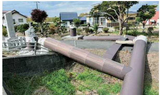
倒壊した鳥居 (新町地区) 平成 30 (2018) 年 9 月 28 日撮影
