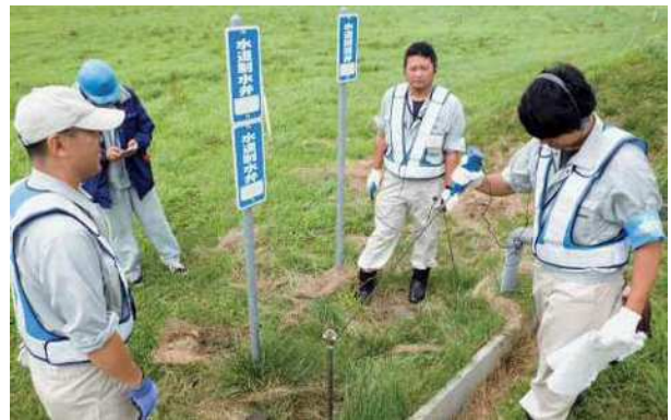
水道漏水調査 平成 30 (2018) 年 9 月 13 日撮影
