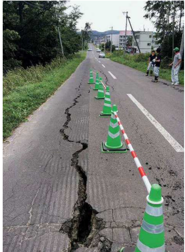
道路被害 (追分安平線) 平成 30 (2018) 年 9 月 7 日撮影
