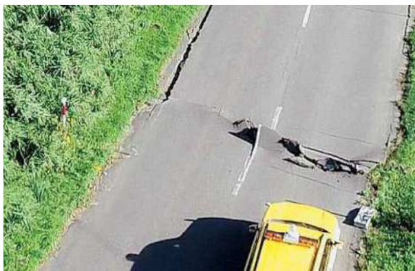
道路被害 (緑丘幌里線) 平成 30 (2018) 年 9 月 6 日撮影
