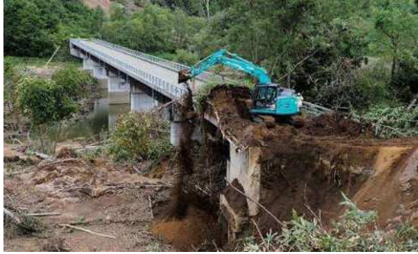
橋梁被害 (瑞穂林道 2 号線) 平成 30 (2018) 年 9 月 13 日撮影
