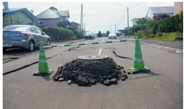
道路被害 (若草団地東 1 条線) 平成 30 (2018) 年 9 月 6 日撮影
