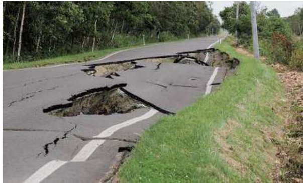
道路被害 (北進緑丘線) 平成 30 (2018) 年 9 月 13 日撮影
