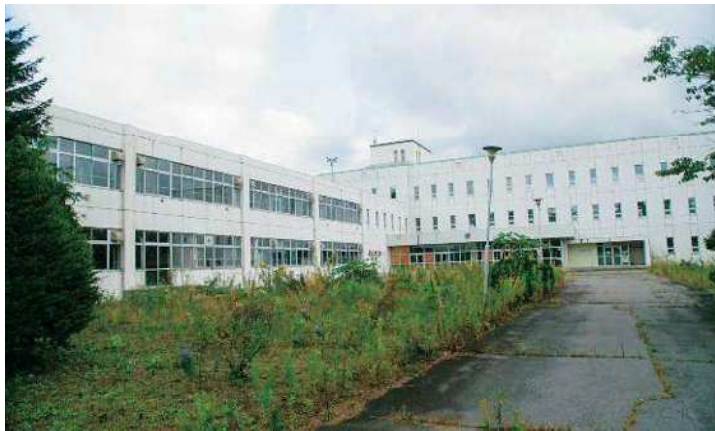
被害を受けて使用できなくなった早来中学校の旧校舎
