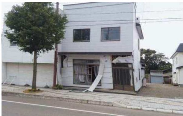
建物被害(鷗川地区) 平成30(2018)年9月6日撮影
