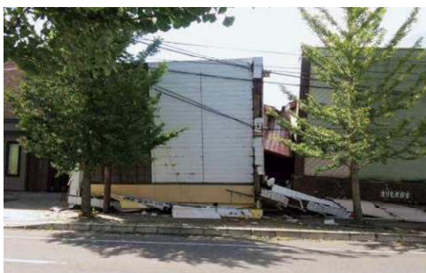
建物被害(鶴川地区) 平成30(2018)年9月6日撮影
