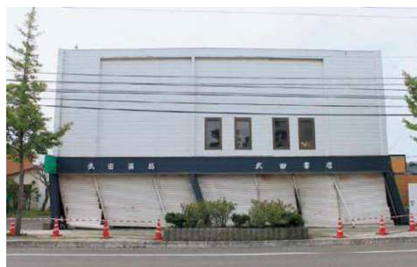
建物被害(鶴川地区) 平成30(2018)年9月7日撮影
