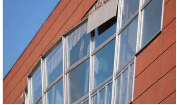
建物被害 (穂別小学校) 平成 30 (2018) 年 9 月 6 日撮影
