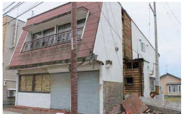
建物被害(鷗川地区) 平成30(2018)年9月7日撮影
