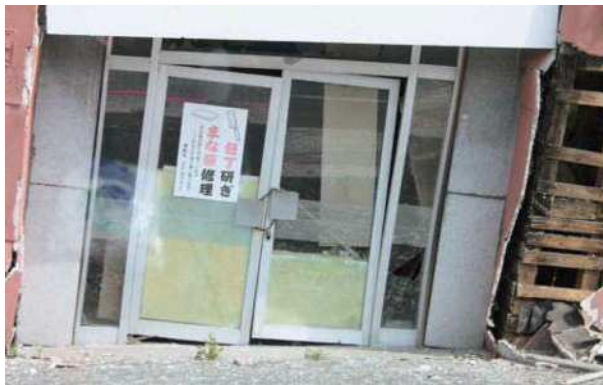
建物被害(鷗川地区) 平成30(2018)年9月7日撮影
