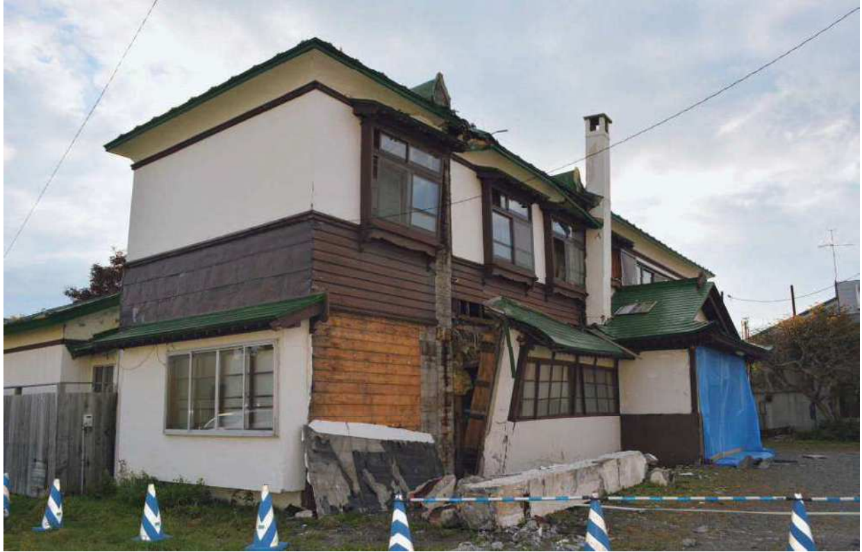
建物被害(鷗川地区) 平成30(2018)年9月28日撮影
