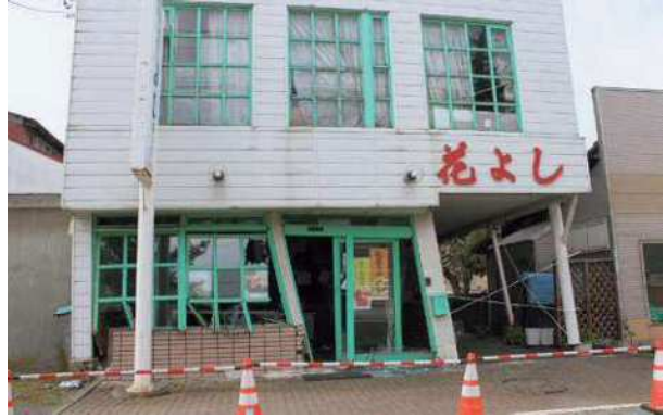
建物被害 (鶴川地区) 平成 30 (2018) 年 9 月 7 日撮影
