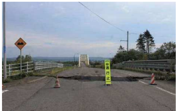
道路被害 (鶴川地区) 平成 30 (2018) 年 9 月 7 日撮影
