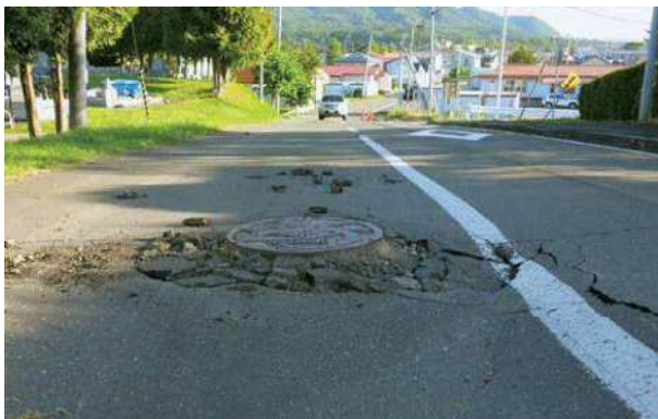
道路被害 (穂別地区) 平成 30 (2018) 年 9 月 7 日撮影
