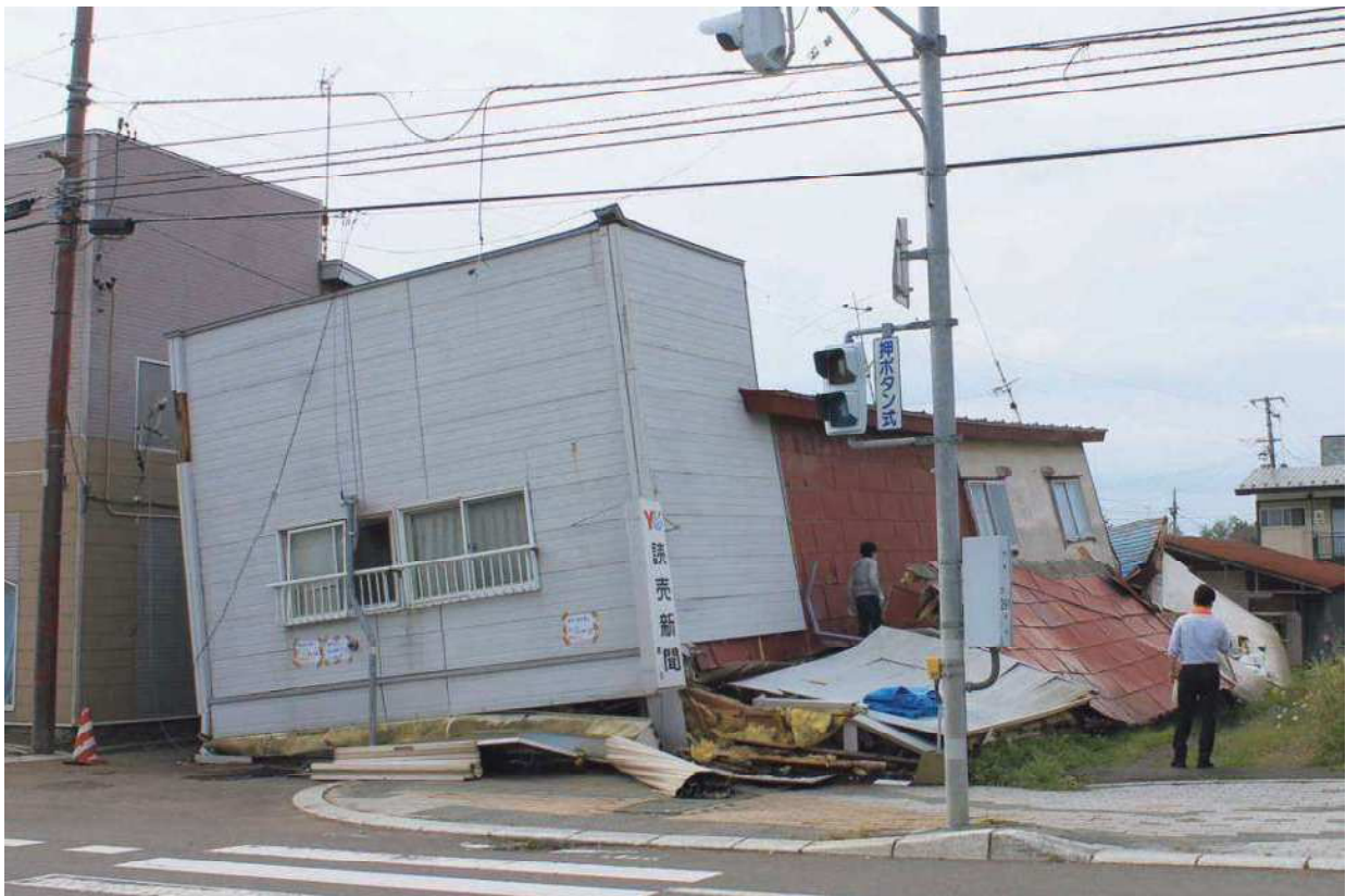
建物被害 (鶴川地区) 平成 30 (2018) 年 9 月 7 日撮影
