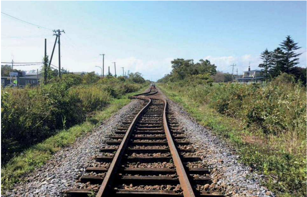
JR 日高線 線路被害 平成 30 (2018) 年 9 月 7 日撮影 [北海道新聞社提供]
