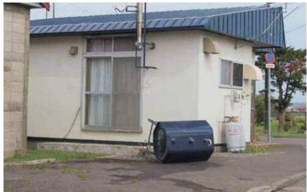
灯油タンク倒壊 (鶴川地区) 平成 30 (2018) 年 9 月 7 日撮影
