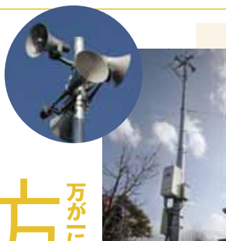
防災行政無線の屋外スピーカー
