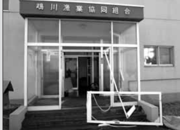
↑正面入口玄関フード破損
