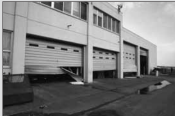
↑1階市場正面シャッター破損
