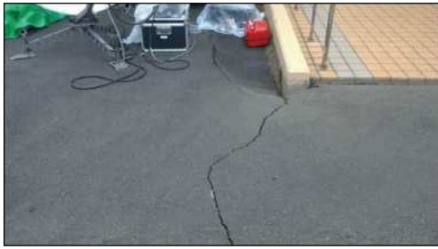
写真1 スロープ下のひび割れ (むかわ町美幸)
