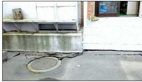
写真2 舗装のひび割れ (むかわ町美幸)
