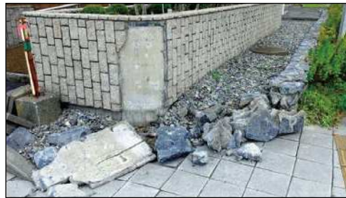
写真4 塀壁の崩れ (むかわ町美幸)
