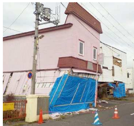
地震の影響で倒壊した建物（鵜川地区）
