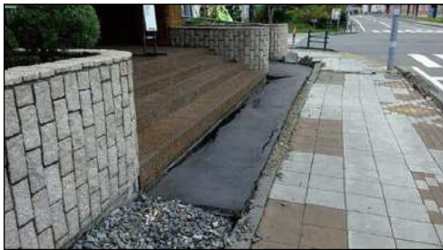
写真3 舗装のひび割れ (むかわ町美幸)
