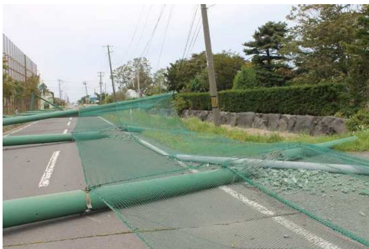
地震の影響で鵜川高校のフェンスが倒壊した
