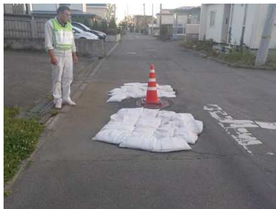
地震の影響で亀裂が入った道路
