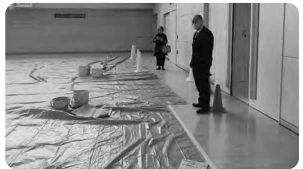
鶴川中学校体育館の雨漏り 1 月
